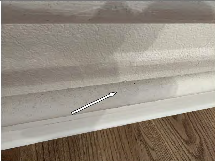
Фото №40. Подтеки краски на трубах отопления в кухне.
