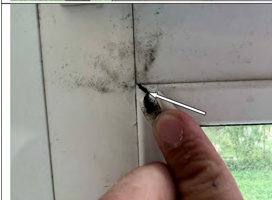
Фото №29. Зазоры в стыках профилей оконного блока ПВХ в кухне.
