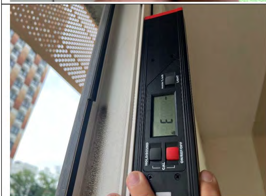
Фото №30. Отклонение оконного блока ПВХ в спальне по уровню вертикальности составляет 3 мм.
