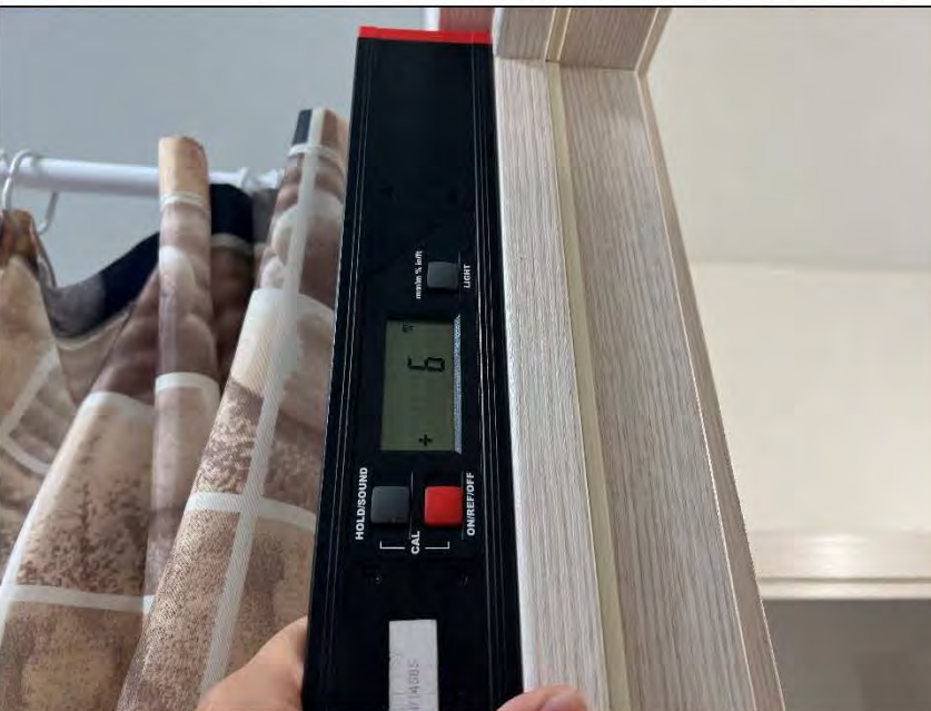
Фото №38. Отклонение коробки от плоскостности и прямолинейности дверного блока в ванной комнате равняется 6 мм.
