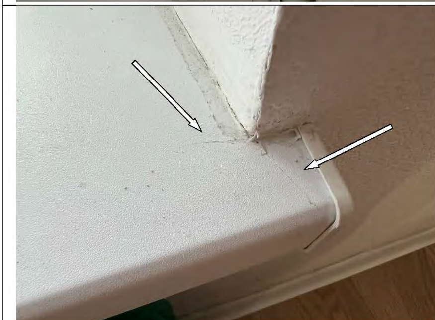
Фото №23. Царапина на лицевой поверхности подоконной доски в кухне.
