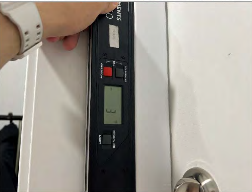
Фото №39. Отклонение коробки входного дверного блока составляет 3 мм.
