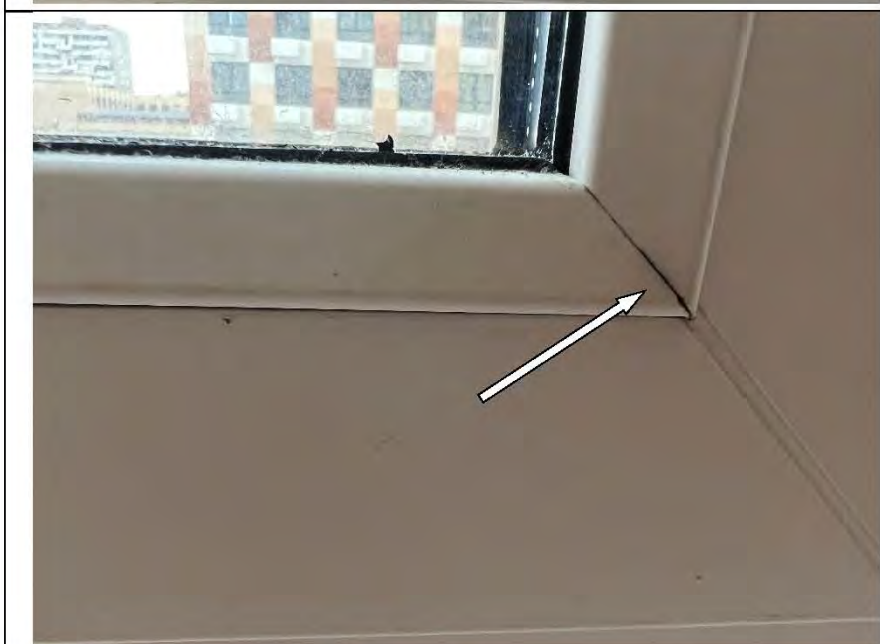
Фото №26. Зазоры в стыках профилей оконного блока ПВХ в спальне.
