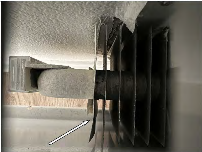
Фото №42. Замытие сот радиатора в спальне.
