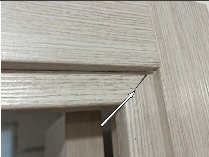
Фото №37. Элементы дверного блока соединены не надежно (короб) в спальне.
