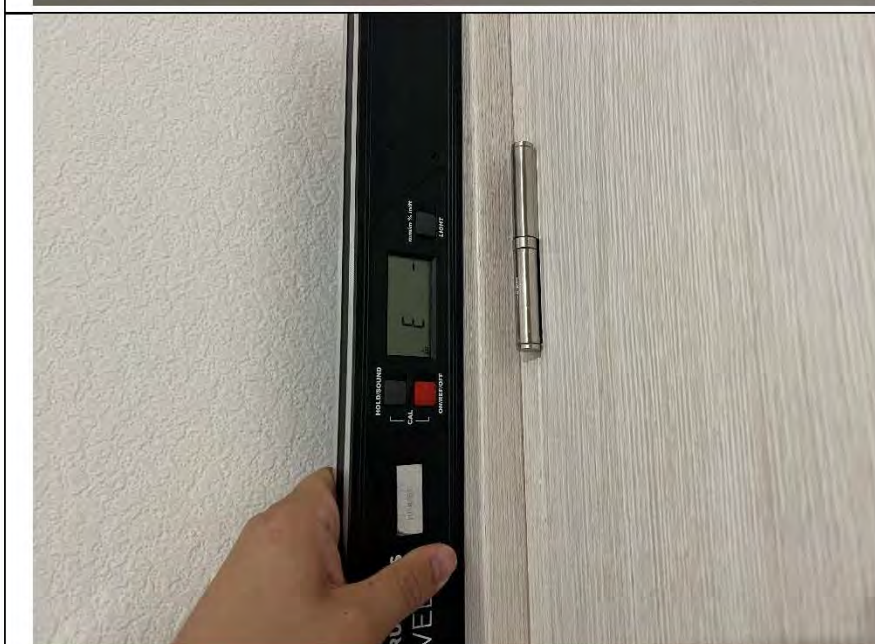
Фото №35. Отклонение наличников дверного блока в спальне равняется 3 мм.
