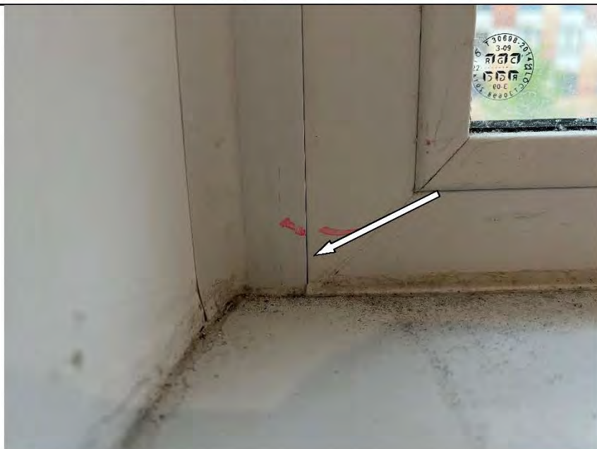
Фото №21. Щель в стыке рамы оконного блока ПВХ и нащельника в спальне.
