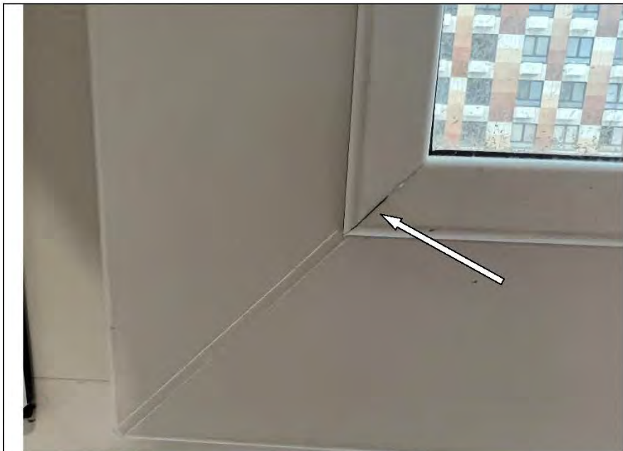
Фото №25. Зазоры в стыках профилей оконного блока ПВХ в спальне.
