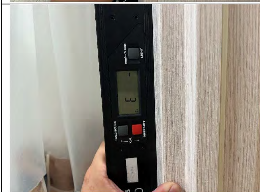
Фото №36. Отклонение наличников дверного блока в ванной комнате равняется 3 мм.
