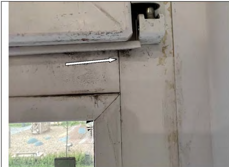
Фото №28. Зазоры в стыках профилей оконного блока ПВХ в кухне.
