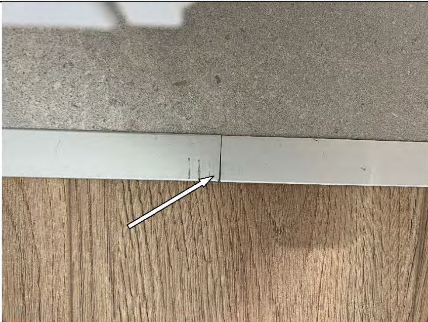
Фото №41. Щель в стыке металлических порошков в кухне.
